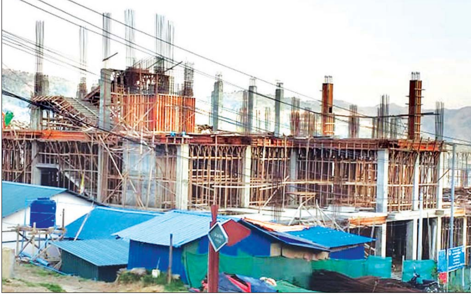
အဖွဲ့(၂) အဆောက်အအုံအထူး အဖွဲ့(၆) အဆောက်အအုံမှာ ဟားခါး-ဖလမ်း-က တာဝန်ယူ တည်ဆောက်လျက်ရှိကြောင်း သိရသည်။ (အပေါ်ပုံ) ပြည်နယ်တရားလွှတ်တော်ရုံး အဆောက်အအုံမှာ ဟားခါး-ဖလမ်း-က တာဝန်ယူ တည်ဆောက်လျက်ရှိကြောင်း သိရသည်။ (အပေါ်ပုံ) ဖွံ့ဖြိုးတိုးတက်မှုနှင့်အတူ မြို့တော်၏ ဂုဏ်ကို ဖော်ဆောင်နိုင်တော့မည် ဖြစ်ကြောင်း သိရသည်။ (အောက်ပုံ) မြိုင်နိုင်စိုး (ပြန်/ဆက်)
